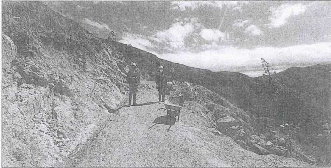
FOTO N° 03: En la imagen se observa al inspector y al analista técnico ubicados en punto donde están realizando los trabajos de un muro seco, para así aumentar el ancho de calzada para dar una buena transitabilidad.
