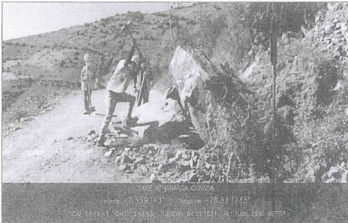
FOTO N° 12: En la imagen se observa que se ha realizado los trabajos de emergencia como la obstrucción de una roca al costado de la calzada.
